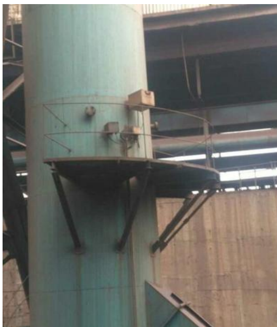
高炉出铁场除尘粉尘仪测点
