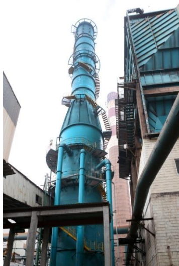
#3 烧结机头脱硫塔
