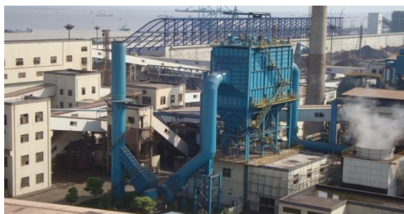
1#高炉矿槽电除尘
