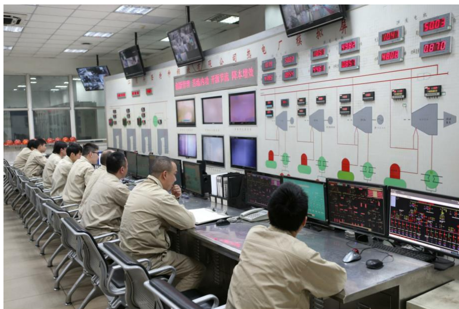
热电厂 5W 机组主控室
