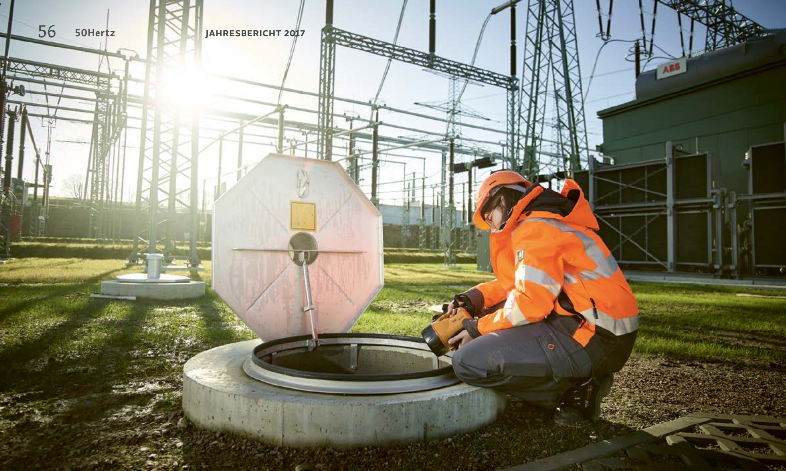
Sabrina Neßmann (Regionalzentrum Süd) kontrolliert im Umspannwerk Röhrsdorf einen Auffangbehälter.
