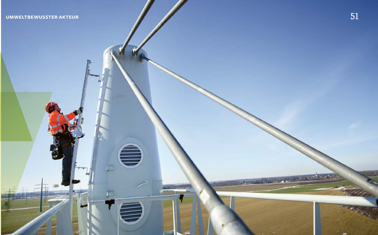
Netzanschluss Jessen/Nord im neuen Mastdesign der compactLine.
