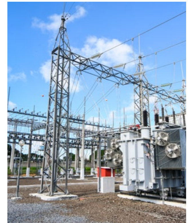
São Mateus Substation, EDP Espírito Santo
