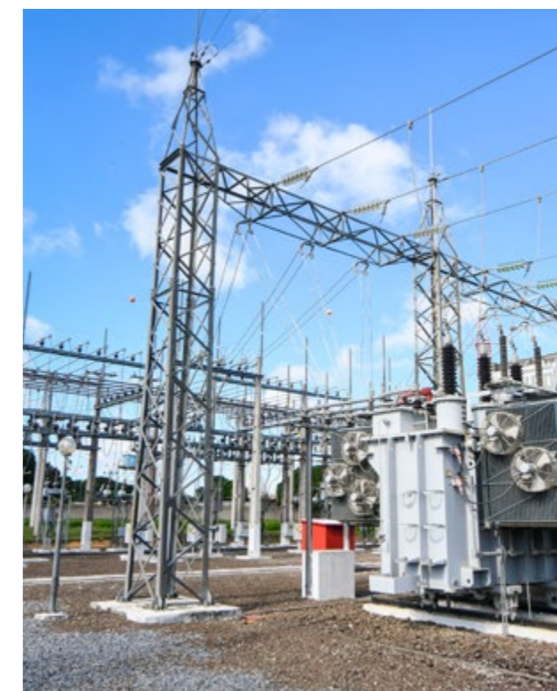
Subestação São Mateus, EDP Espírito Santo
