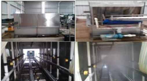
Figura 2. Lavado de contenedores de cajas de plástico. Sistema de aspersión de agua.
