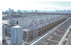
屋上クーリングタワー
