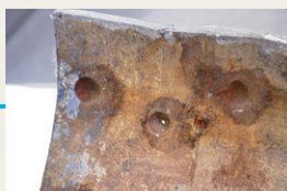
局所的に丸く削られたような症状の腐食
