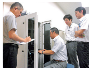
サーバーの監査状況
