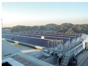
ソーラー式給湯システム
