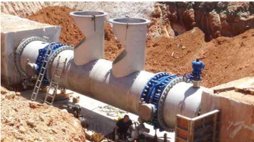
Tuberías de conexión Loaysa-Conejeras
