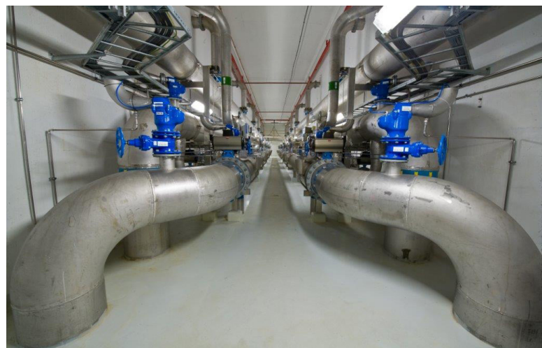
Svartediket vannbehandlingsanlegg i Bergen. Foto: Eilif Stene
