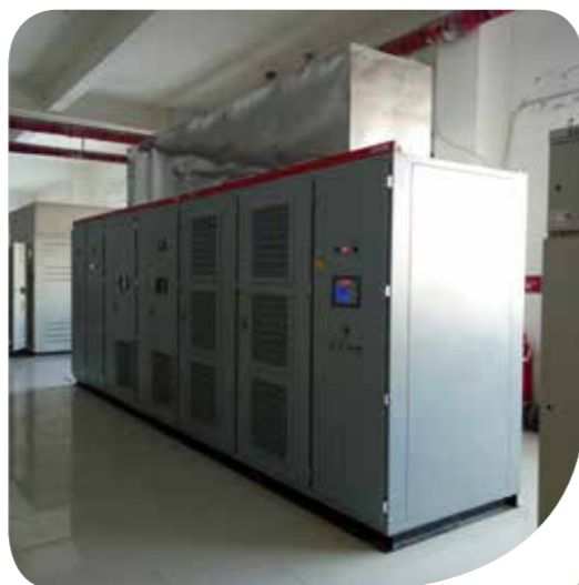
浮选鼓风机高压变频节能技术改造项目
