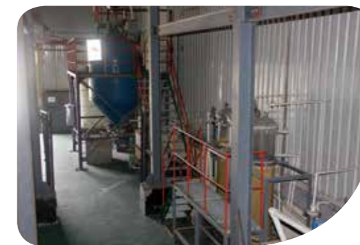
内蒙古太平公司循环液除杂设备
