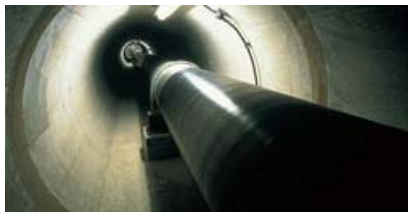
高圧ガス導管
