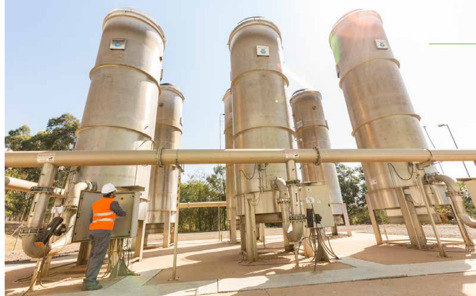
Central de queima de biogás em Paulínia (SP)
