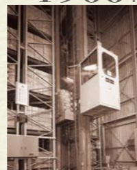
松下電器産業様に納入された「ラックビル」
