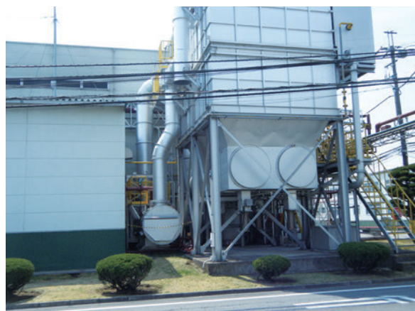
熊谷工場のVOC排熱回収ボイラー
