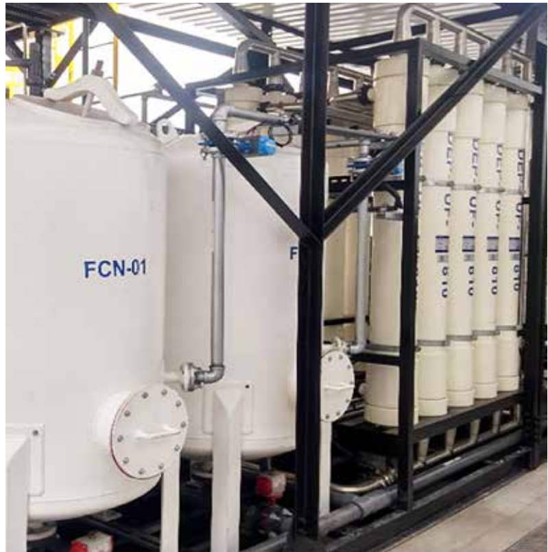
Proyecto de recirculación de agua de autoclaves, Negocio Cárnicos.
