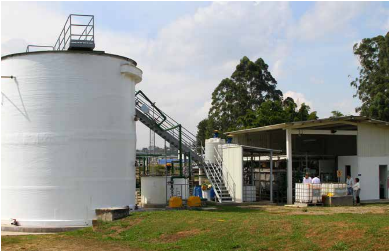
Planta de tratamiento de aguas residuales, Compañía Nacional de Chocolates Rionegro.
