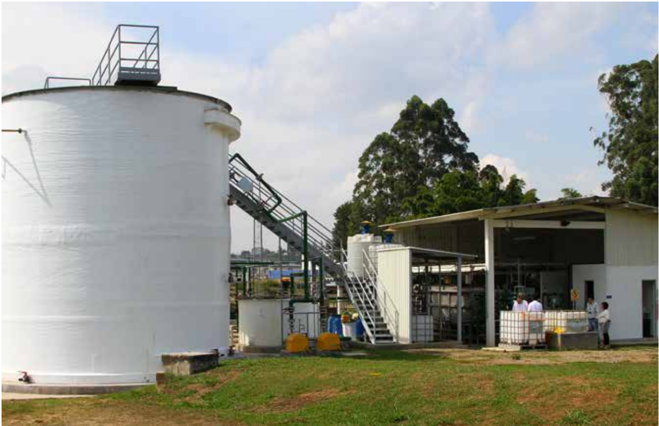
Waste water treatment plant, Compañía Nacional de Chocolates, Rionegro.
