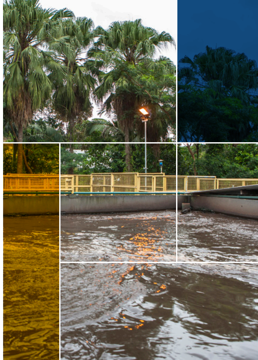
Sistema de tratamiento de efluentes en la Unidad de Joinville.
