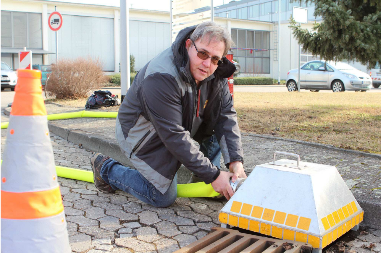
Ralf Sandtner hat mit seiner Erfindung die Hygienespülung von Trinkwasserrohren deutlich erleichtert
