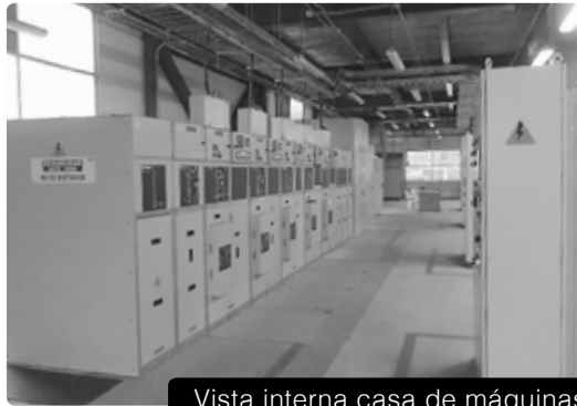
Vista interna casa de máquinas
