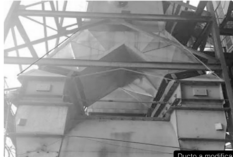
Ducto a modificar
