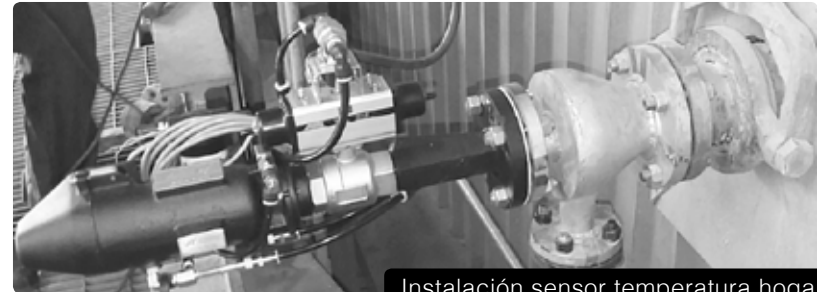
Instalación sensor temperatura hogar
