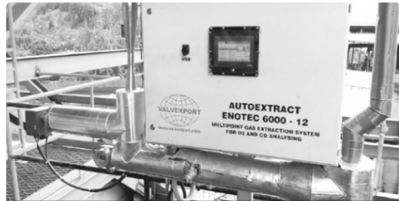
Instalación sistema de extracción y análisis de gases de combustión.
