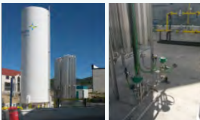
LNG Plant in Sotillo de la Adrada (Ávila)
