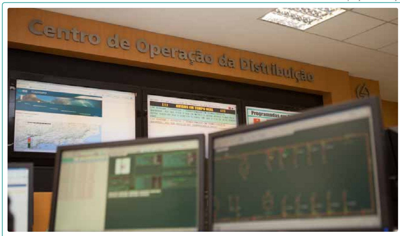
Centro de Operação da Distribuição
