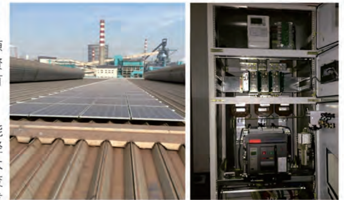
▲ 为节能减排，兴澄积极扩大可再生能源的应用，图为公司的太阳能发电机组
