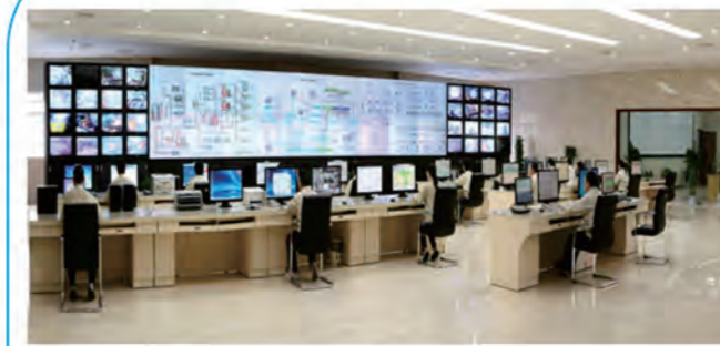
▲ 兴澄特钢能源管控中心系统主画面分为三个子系统：动力系统、水系统、电力系统。
