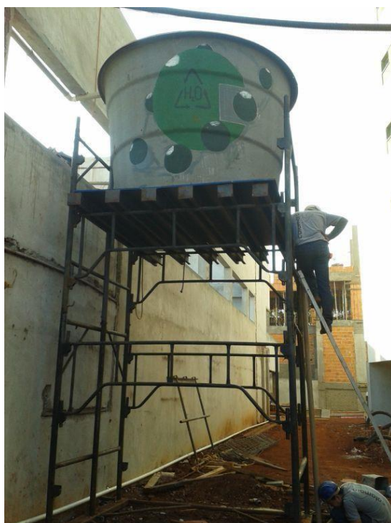
FOTO 2: CAPTAÇÃO E REUTILIZAÇÃO DE ÁGUAS PLUVIAIS NO CANTEIRO DE OBRAS
