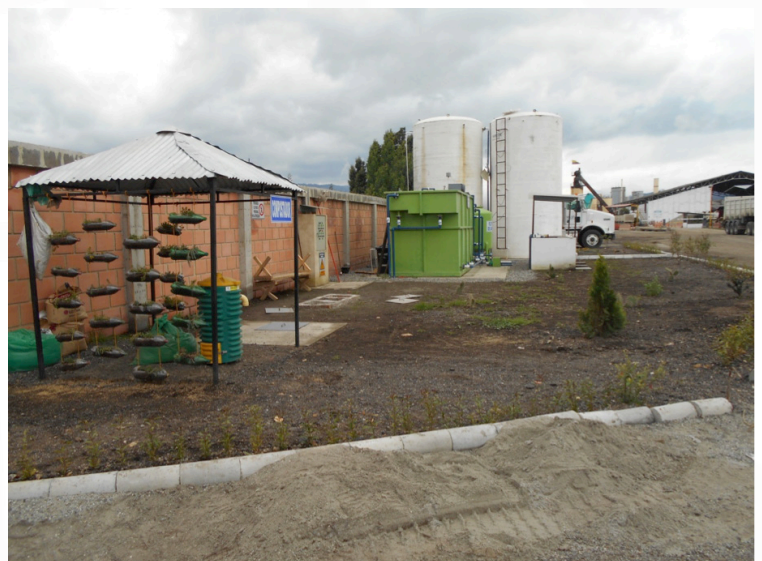
Fotografía No. 2: PTARD vista lateral
