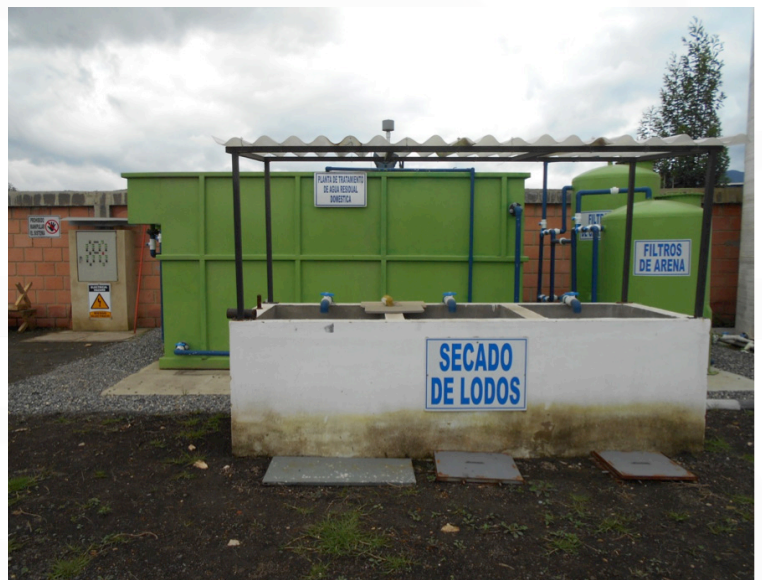
Fotografía No. 1: PTARD vista frontal
