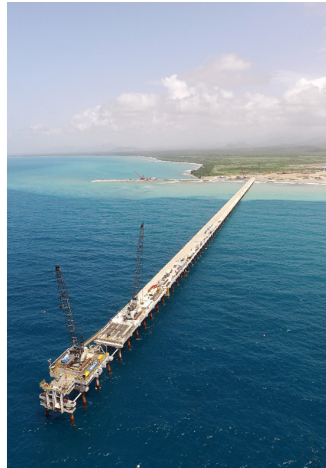
O terminal marítimo, que recebe o carvão, na Central Termoelétrica de Punta Catalina, na República Dominicana
