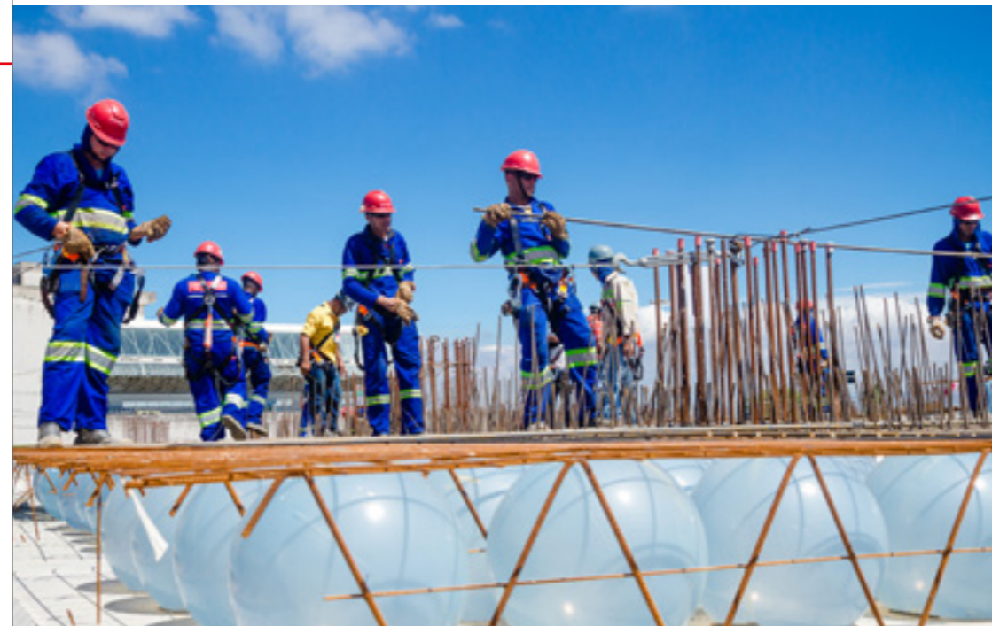
A tecnologia Bubbledeck foi utilizada nas lajes do Centro Administrativo do Distrito Federal
