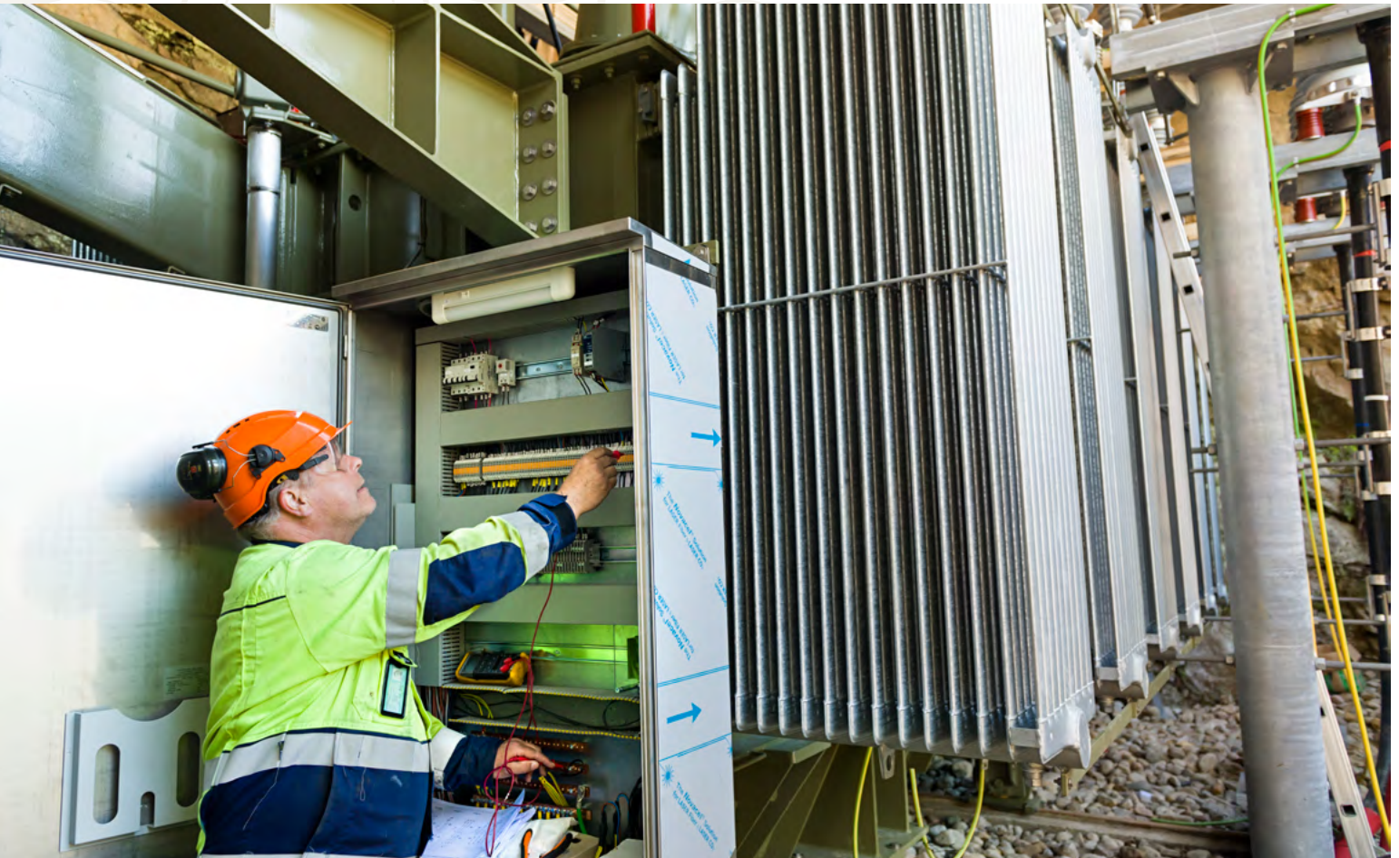
Stasjonsleder Lars Helge Bratteli på jobb i Kulia transformatorstasjon i Kristiansand.
