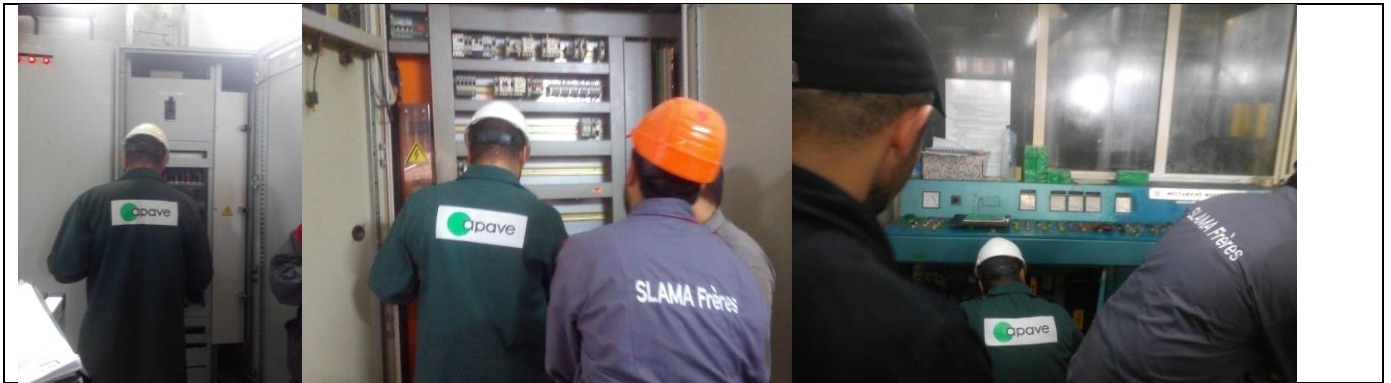
Visite semestrielle de contrôle de l'état des installations électriques par l'apave.
