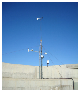
Estación Meteorológica Dique Este Sagunto
