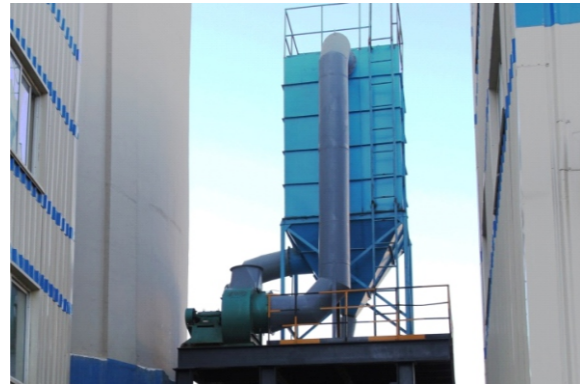
河北东梁公司除尘设备
