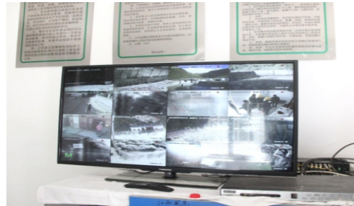
西藏华泰龙公司炸药库监控系统
