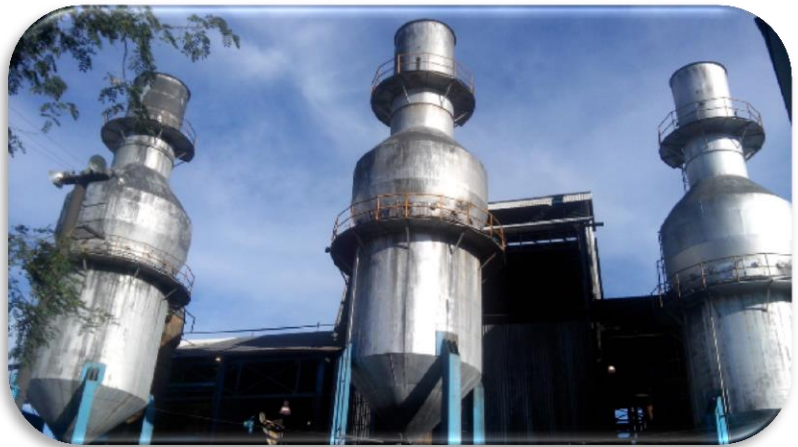
Paraklones: Calderas 3, 4 y 5
