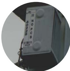
Marcado y rotulado en poste 2015
