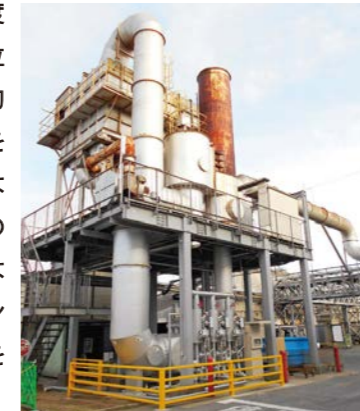
千葉工場の排熱ボイラー
