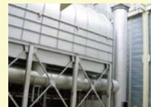
VOC熱焼却設備
