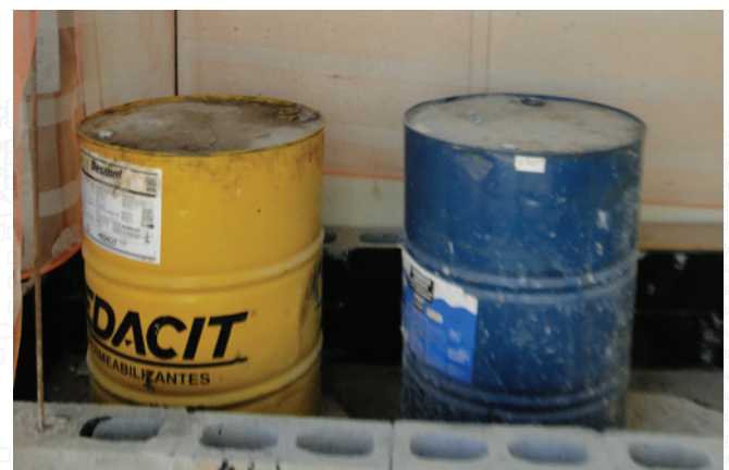
Baia de contenção para produtos químicos
