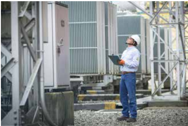
Subestación Nueva Esperanza
