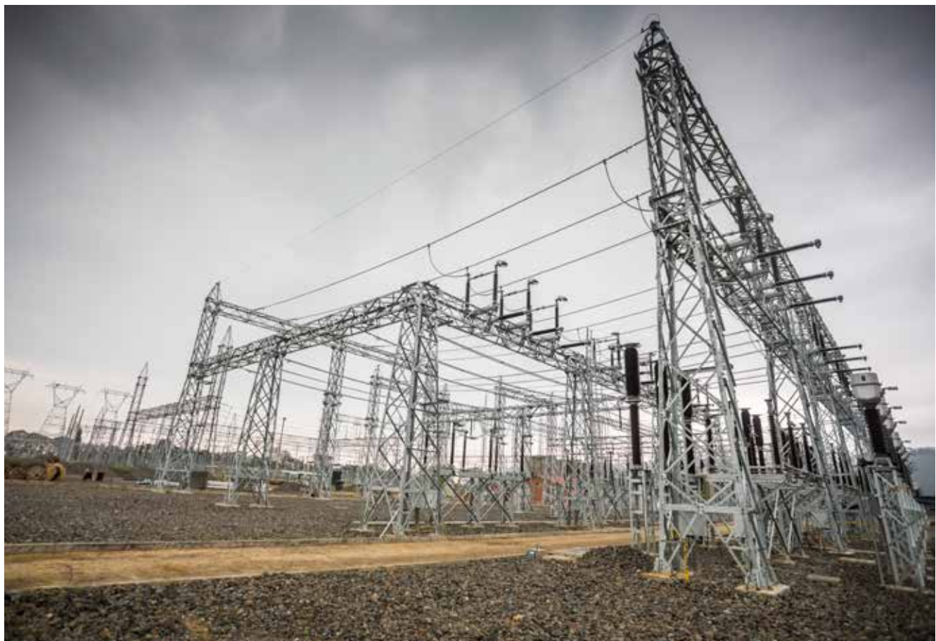
Subestación Nueva Esperanza
