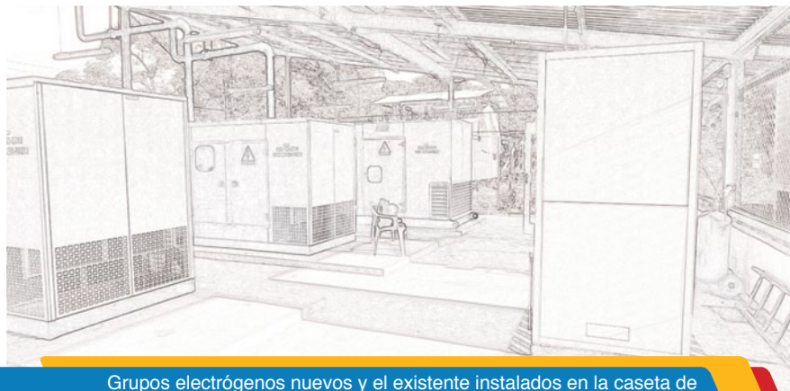
Grupos electrógenos nuevos y el existente instalados en la caseta de generación del municipio de Litoral de San Juan en el departamento del Chocó.
