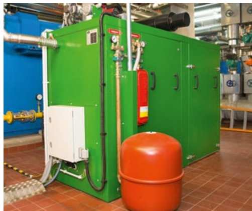
Blockheizkraftwerk am Standort Frankfurt am Main
