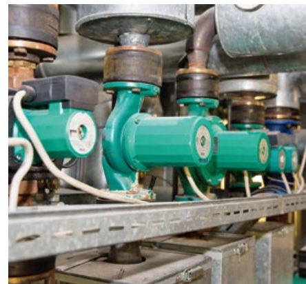
Hocheffizienzpumpen der Heizungsanlage am Standort Frankfurt
