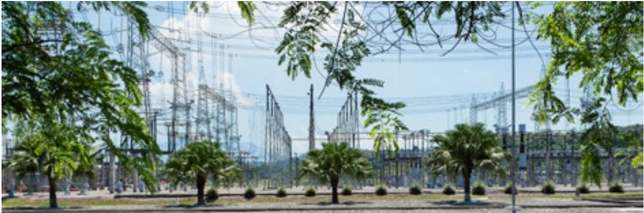
Subestación de São Jose (RJ)
