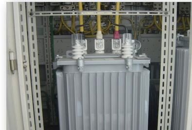
高効率変圧器(三重工場)
