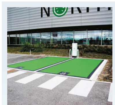
Estación de carga eléctrica o "electrolinera" en la sede de Northgate.
