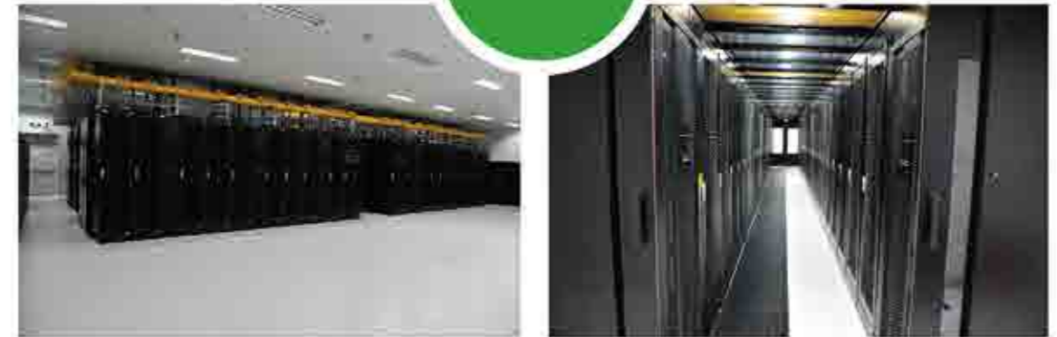
数据中心（上海） 嘉定园区机柜机房 设置冷热通道封闭
