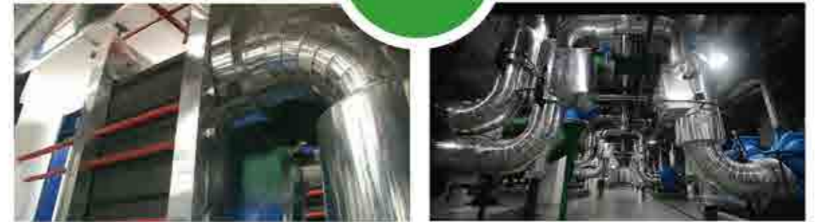
数据中心（上海） 水冷系统
