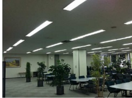
羽村技術センターロビーのLED照明
