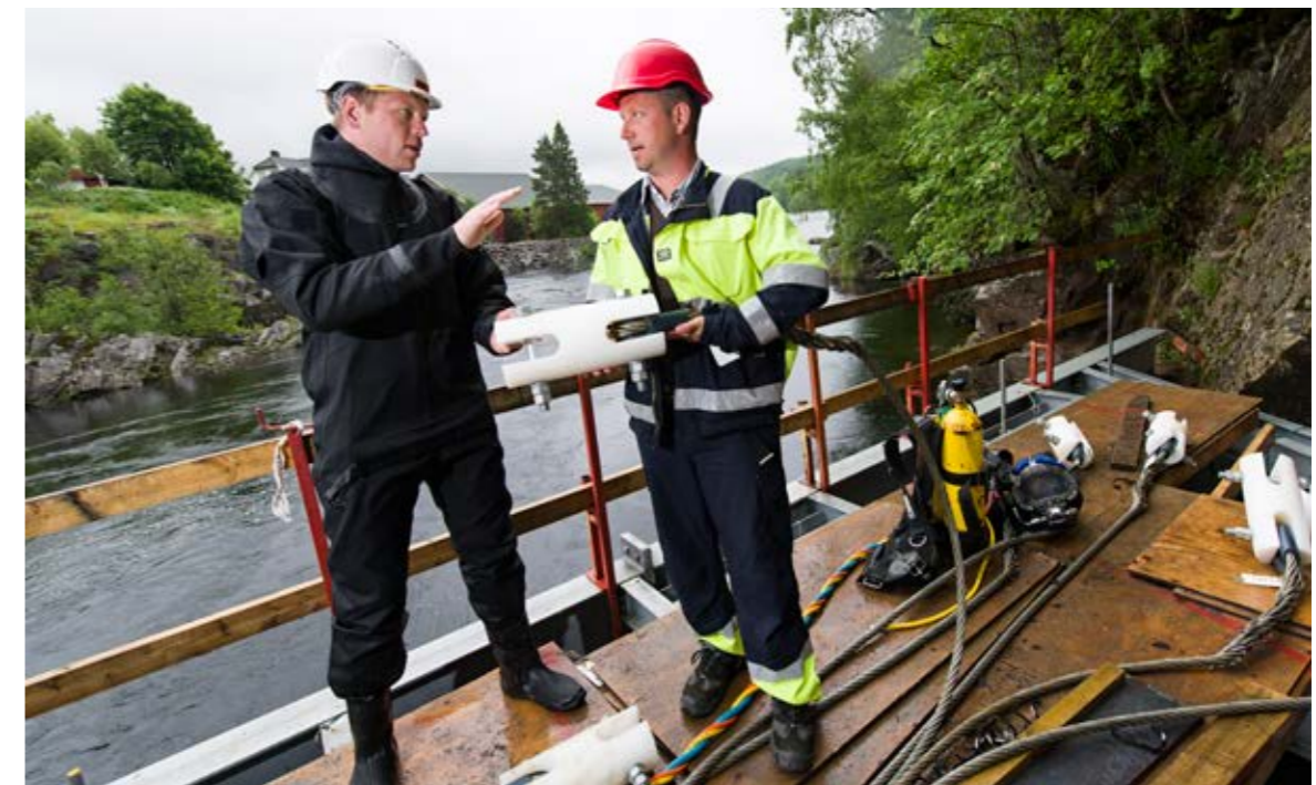
En moderne elektrisk fiskesperre skal stenge laksen ute fra kraftverket på Rygene i Aust-Agder. Prosjektleder Aleksander L. Andersen (t.h.) og dykker Magnus Antonsen studerer utstyret som skal holde laksen unna kraftverket.
