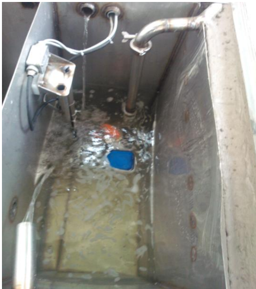
Foto 5: Tanque subterráneo sistema de recirculación de agua,
