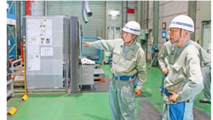
社長(右)が率先して据付工事現場の安全パトロールを実施
