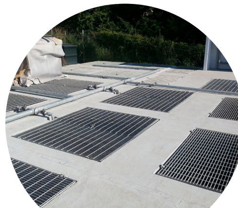
CELDA DE TRATAMIENTO DE AGUAS NEGRAS
