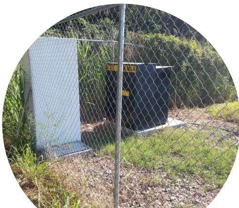
SUBESTACIÓN ELÉCTRICA Y CONTROLES
