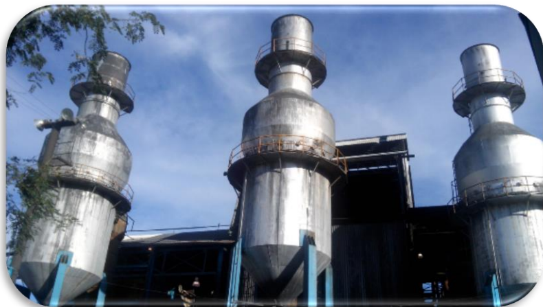
Paraklones: Calderas 3, 4 y 5
