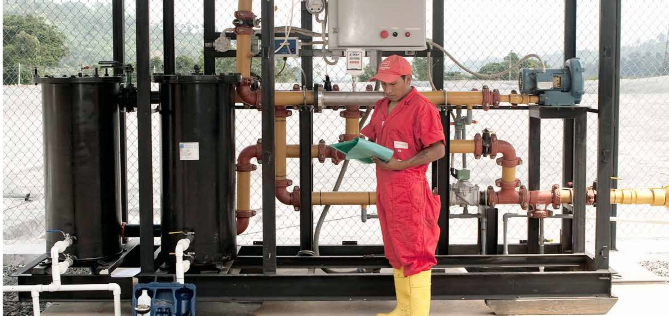
Control en Biodigestor. Granjas Toachi.
