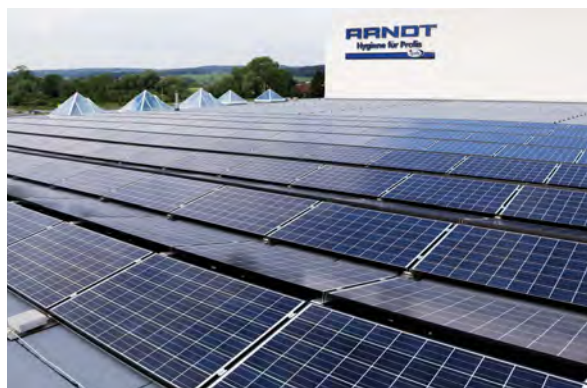
Photovoltaikanlage in Memmingen
