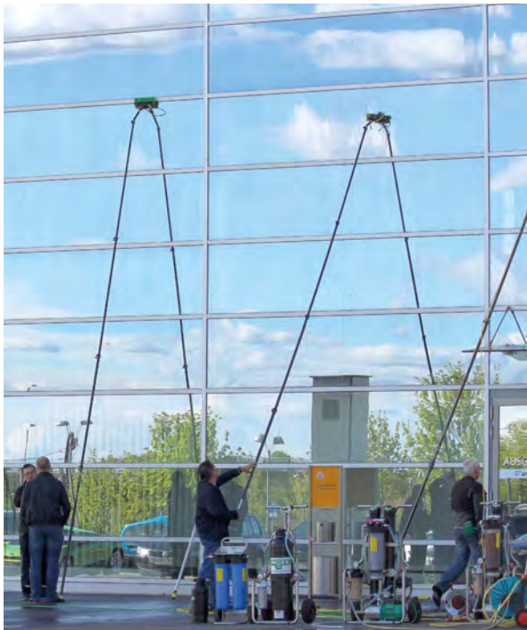
Die Reinigung mit Reinwasser ist für große Flächen wie Glasfassaden, aber auch Photovoltaikanlagen hervorragend geeignet
