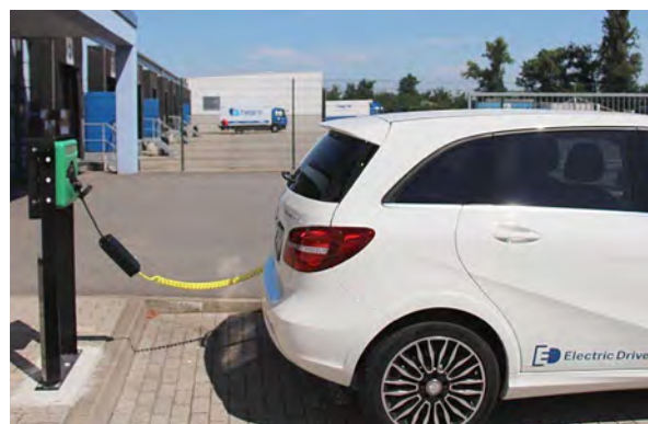
Energietankstelle in Büttelborn
