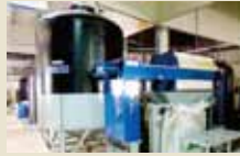
排水処理設備
