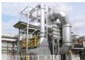
新宮事業所に設置した排熱ボイラー
