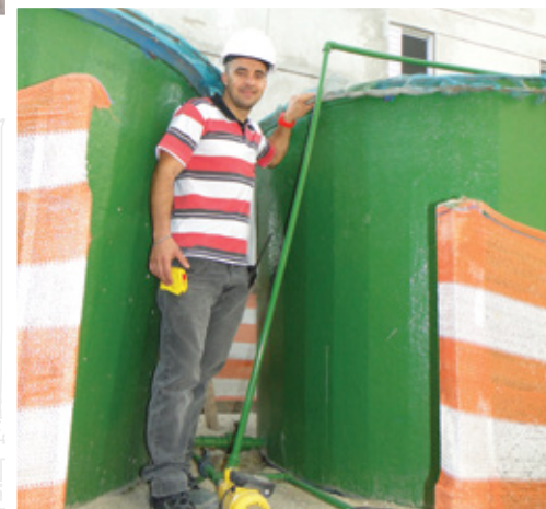
O sistema de captação de água da chuva já economizou mais de 211 mil litros de água
