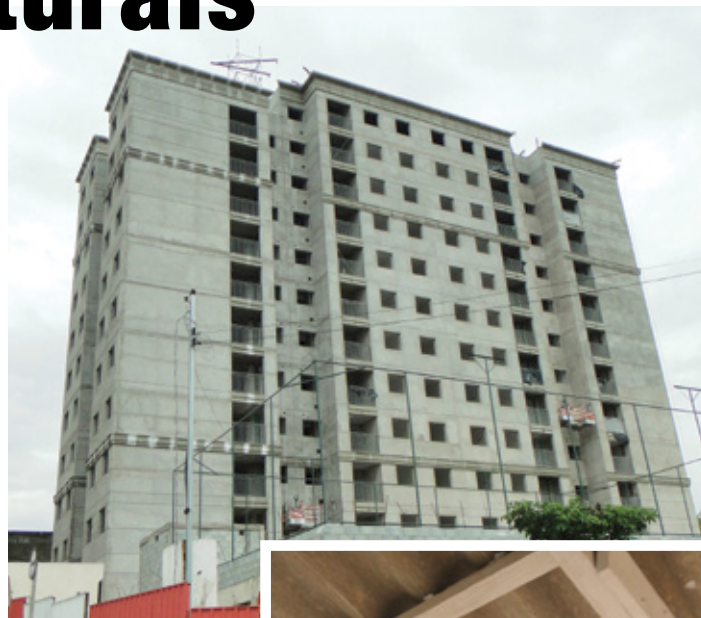
Instalado na obra Piemonte (B. Saúde/SP), o sistema capta água da chuva, por meio das calhas do telhado
