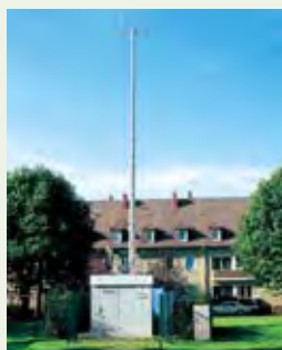
大気汚染監視分析装置
